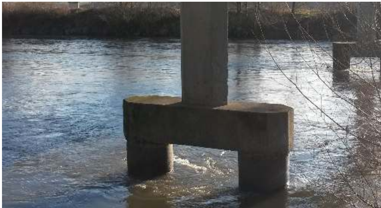
Affouillement (passerelle sur l'Allier)
