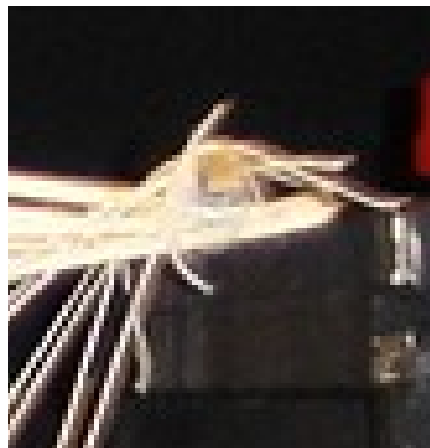
Détail de l'appui où se produit la rupture
