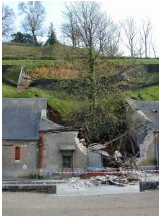
Figure 2.2. Seconde phase du glissement de terrain
