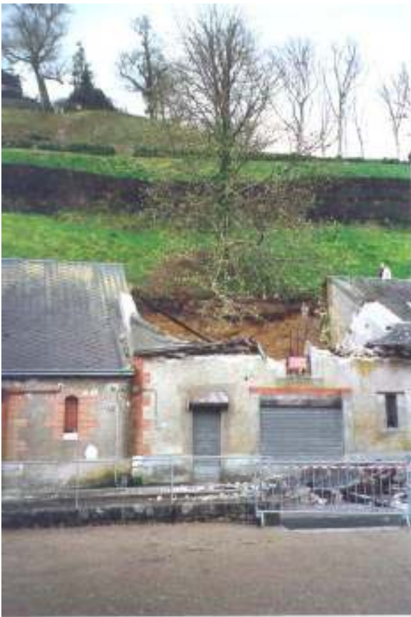
Figure 2.1. Première phase du glissement de terrain
