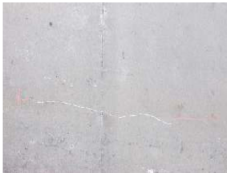
Photo n° 11: Fissures sur la travée, avec leur évolution marquée à la craie rouge
