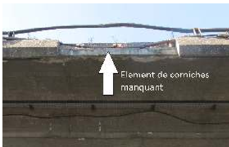
Photo n° 2 : Élément de corniche manquant
