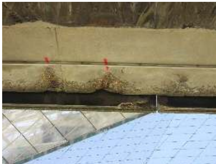
Photo n° 16 : Aciers corrodés sur les côtés latéraux du tablier
