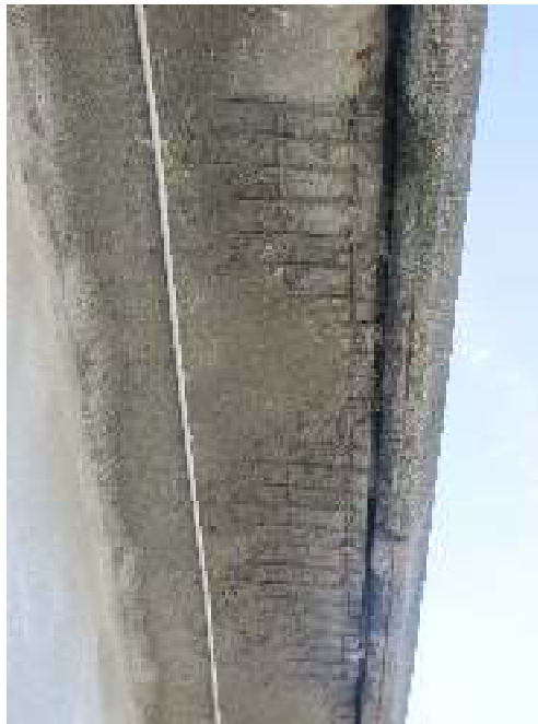
Photo n° 8: Les corniches dégradées sur la Culée Nord
