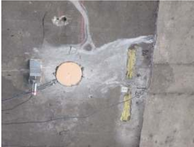
Photo n° 12 Présence d'appareil d'auscultation sous le tablier
