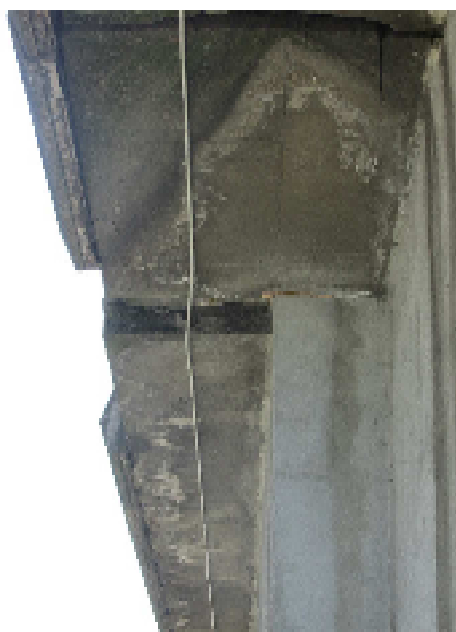
Photo n° 7: Les corniches dégradées sur la Culée Sud
