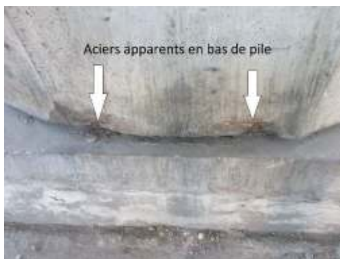
Photo n° 5: Pas de la pile 5 dégradée
