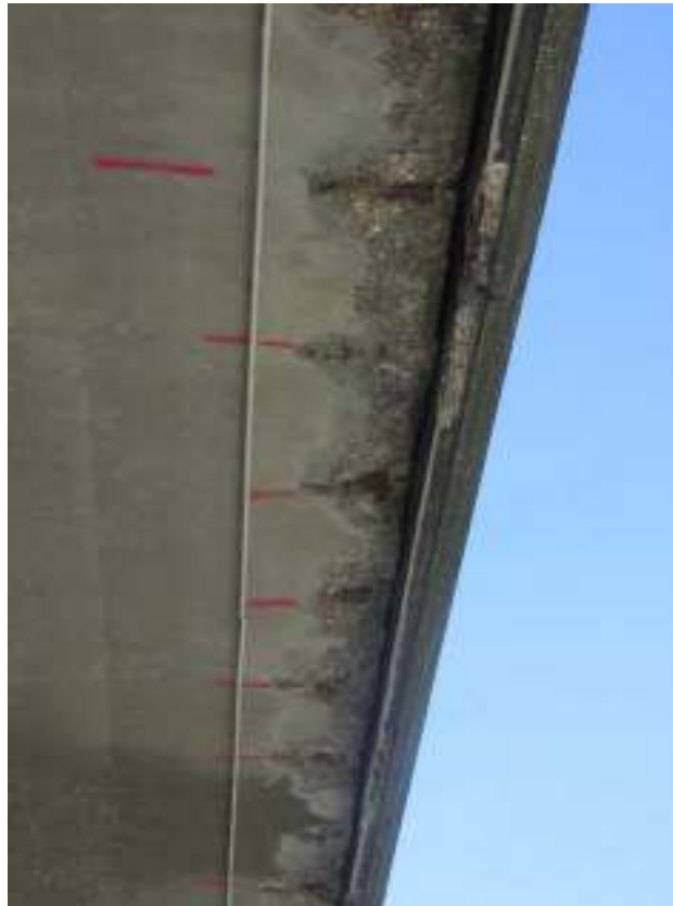
Photo n° 17 : Aciers corrodés sur les côtés latéraux du tablier (2eme photo)
