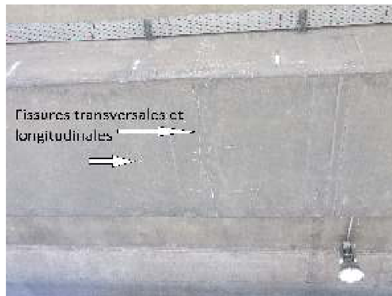
Photo n° 10: Fissures sur la travée
