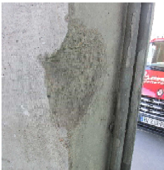
Photo n° 4 : Dégât sur le béton des piles
