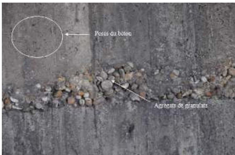
Figure 15 : Surface du béton constituant la culée Sud C0 (Photo 4)
