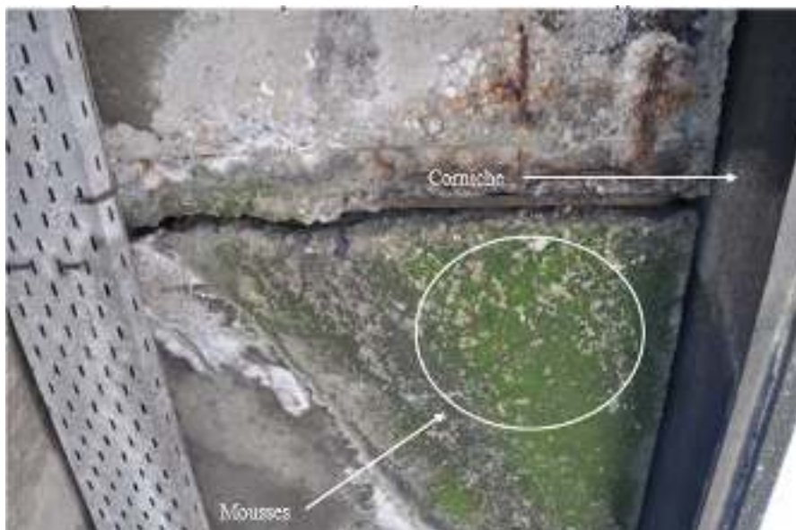
Figure 17 : Développement de mousses au niveau de la rampe d'accès sud (Photo 6)
