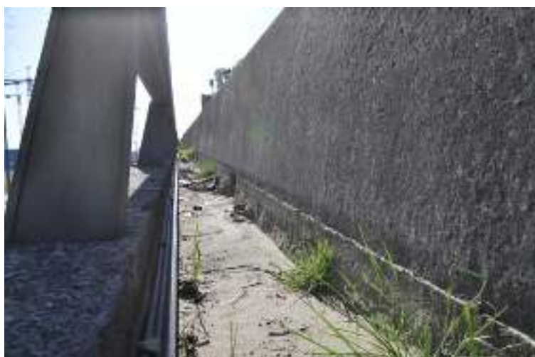
Figure 11 : Obstruction du caniveau par la végétation (Photo 7)
