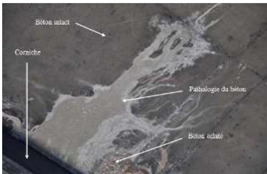
Figure 19 : Détérioration caractéristique du béton du tablier au droit des dispositifs d'évacuation de l'eau (Photo 12)
