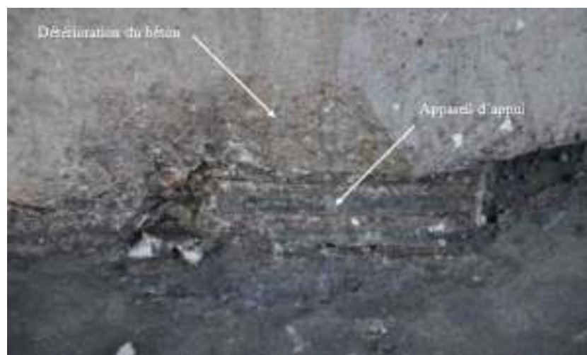
Figure 13 : Appareil d'appui de la pile P4D (Photo 10)
