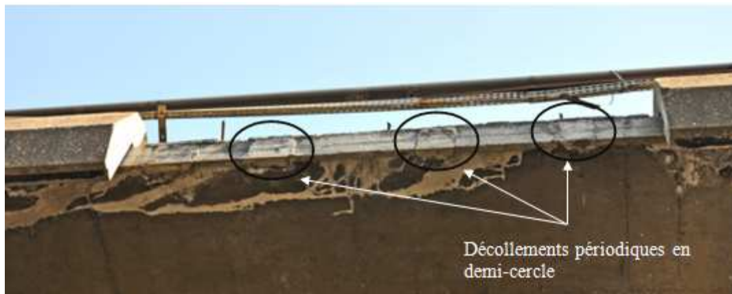
Figure 20 : Répétition des motifs de dégradation du béton (Photo 13)
