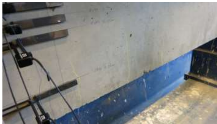
Figure 6: début de fissuration au centre de la poutre
