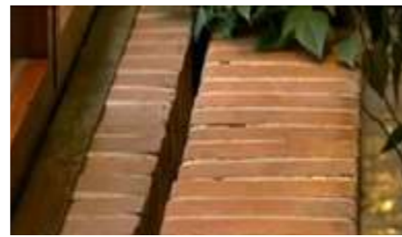
Banquette dans une des coursives entourant le patio. Un radiateur se situe en dessous, et l'espace entre les briques reliées aux vitres et celle de la banquette empêche un pont thermique
